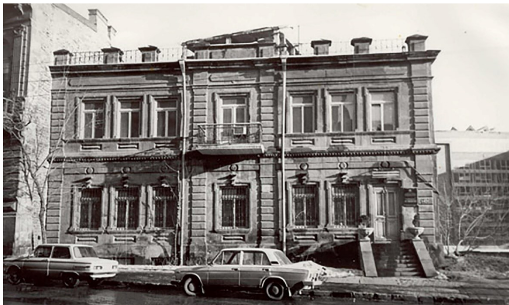
Ил. 3. Доходный дом на улице Налбандяна, конец XIX в. Фотография автора Fg.3. Apartment house on Nalbandyan Street, late 19th century. Photo of the author
