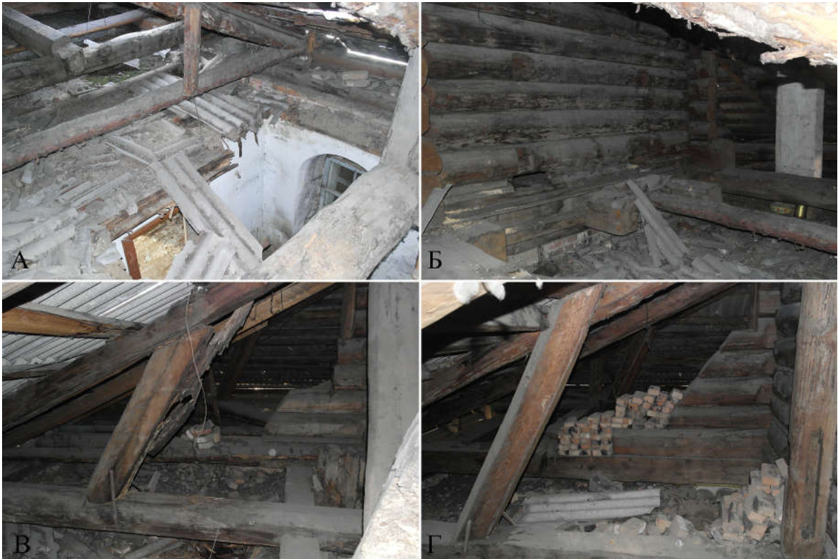
Ил. 1. Места отбора проб с перекрытий и каланчи «Дома воеводы» (ПМА): А — западная сторона; Б — западная сторона каланчи; В — юго-восточный угол; Г — юго-западный угол
