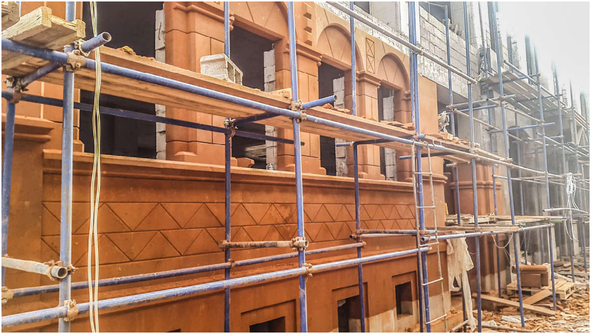
Ил. 5. Процесс строительства, 2019 г. Двухэтажный, с двухэтажным подвалом дом Аветиса Мирзояна на Назаровской (ныне Амиряна) улице, 1881 г. Разрушен в 2000-х гг., воссоздается по чертежам и старым фотографиям. Снимок Л.Л. Варданян
