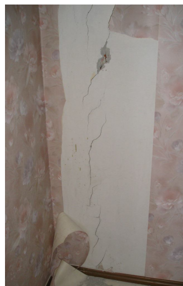
Рис. 2. Сквозные трещины в несущей внутренней стене на 3-м этаже
