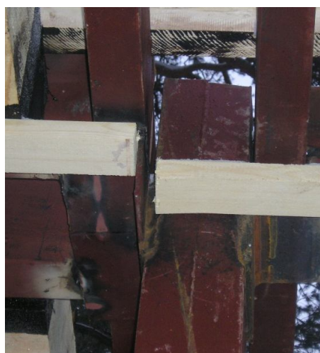
Рис. 7. Зазоры между поперечными балками и стойкой рамного каркаса. Отсутствие верхней соединительной пластины
